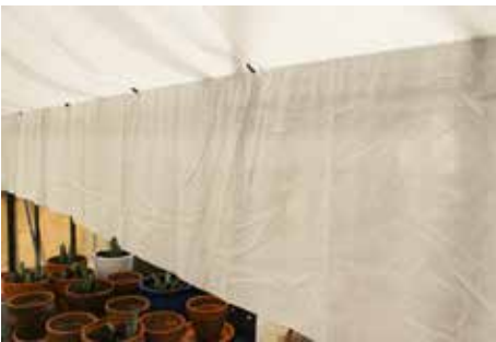
Système d'ombrage Beschattungssystem Shading system
